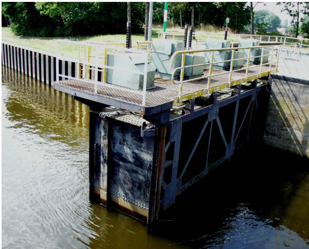
Abb. 6: Alle Schiebetore sind im Rahmen der Grundinstandsetzung zu erneuern.
